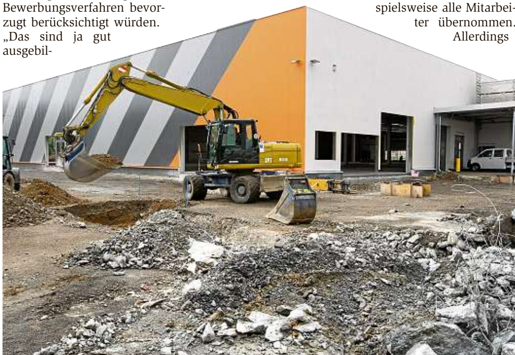
Auf einer Brachfläche im östlichen Teil des Grundstückes entstand derweil ein großzügiger Anbau.
