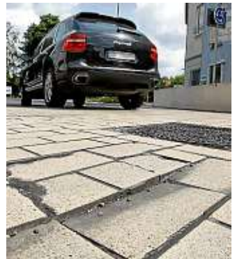
An der Bahnhofstraße müssen Mängel am Pflaster behoben werden. Foto: Milk
